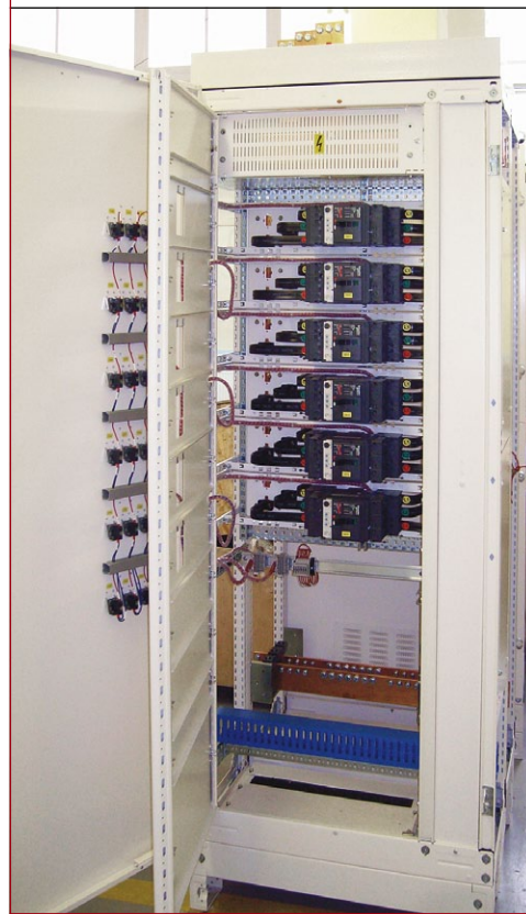
ЩСН. Панель отходящих линий
